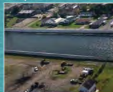
Đê được cải tạo, New Orleans, Louisiana
