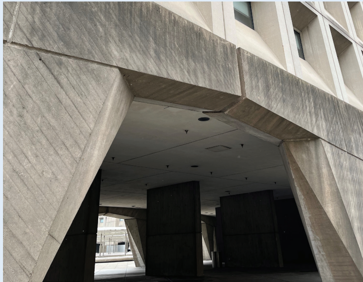
Figura 17: Una pared del edificio se ennegreció con el tiempo debido a material particulado en el aire.
