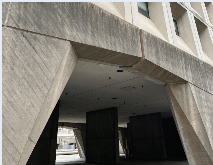
Figure 17 : Un mur de bâtiment noirci au fil du temps par les matières particulaires dans l'air.
