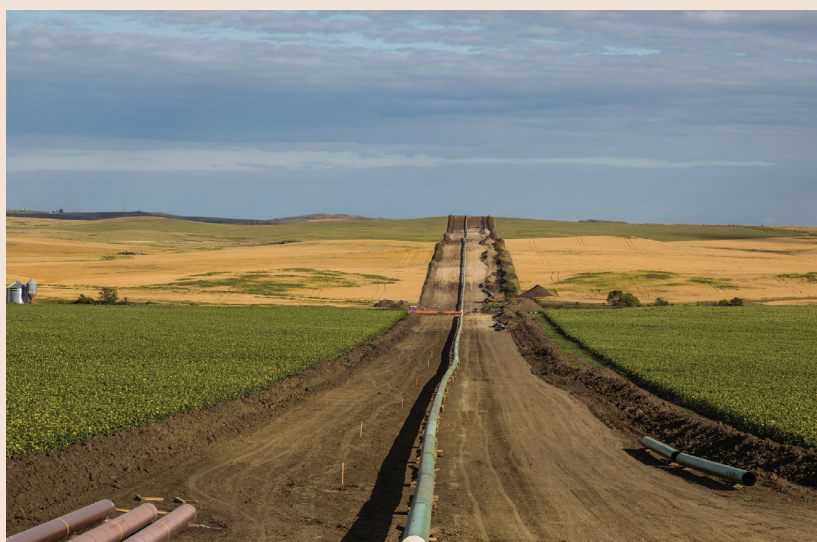
Figure 28 : l'oléoduc Dakota Access Pipeline.
