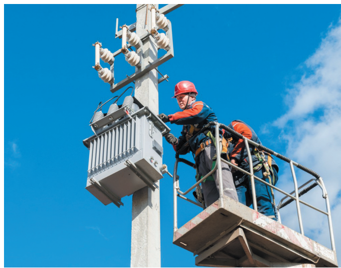
Белгородские энергетики смонтировали 26 комплектных трансформаторных подстанций.
