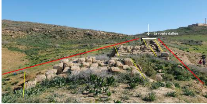
Figure 42. Vue des extrados des arches montrant le non alignement des rangs de pierre de taille avec le sens du tablier.
