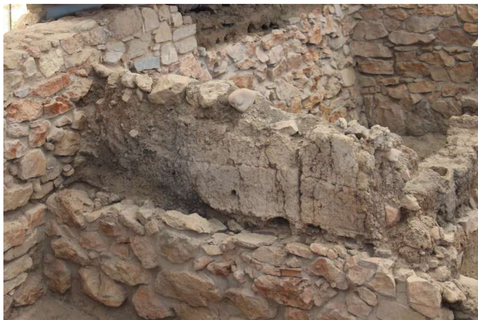
Figura 49. Muro de tapial en Libisosa. Se observan improntas del encofrado (foto: autores).
