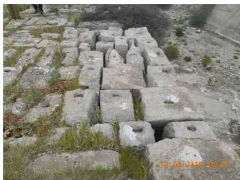
Figure 19. Traces d'instabilité visibles sur les blocs de tablier au niveau des arches n° 5 et 6. [cliché M. Grira, avril 2019].
