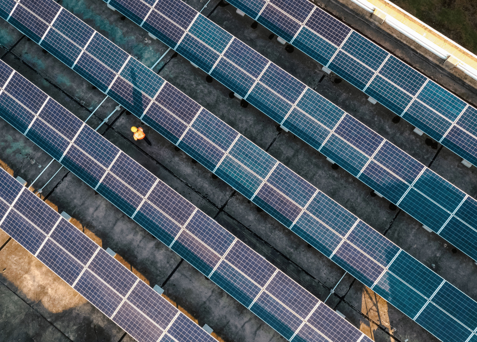
Appleのサプライヤーに電力を 供給するためのソーラーパネル 中国
