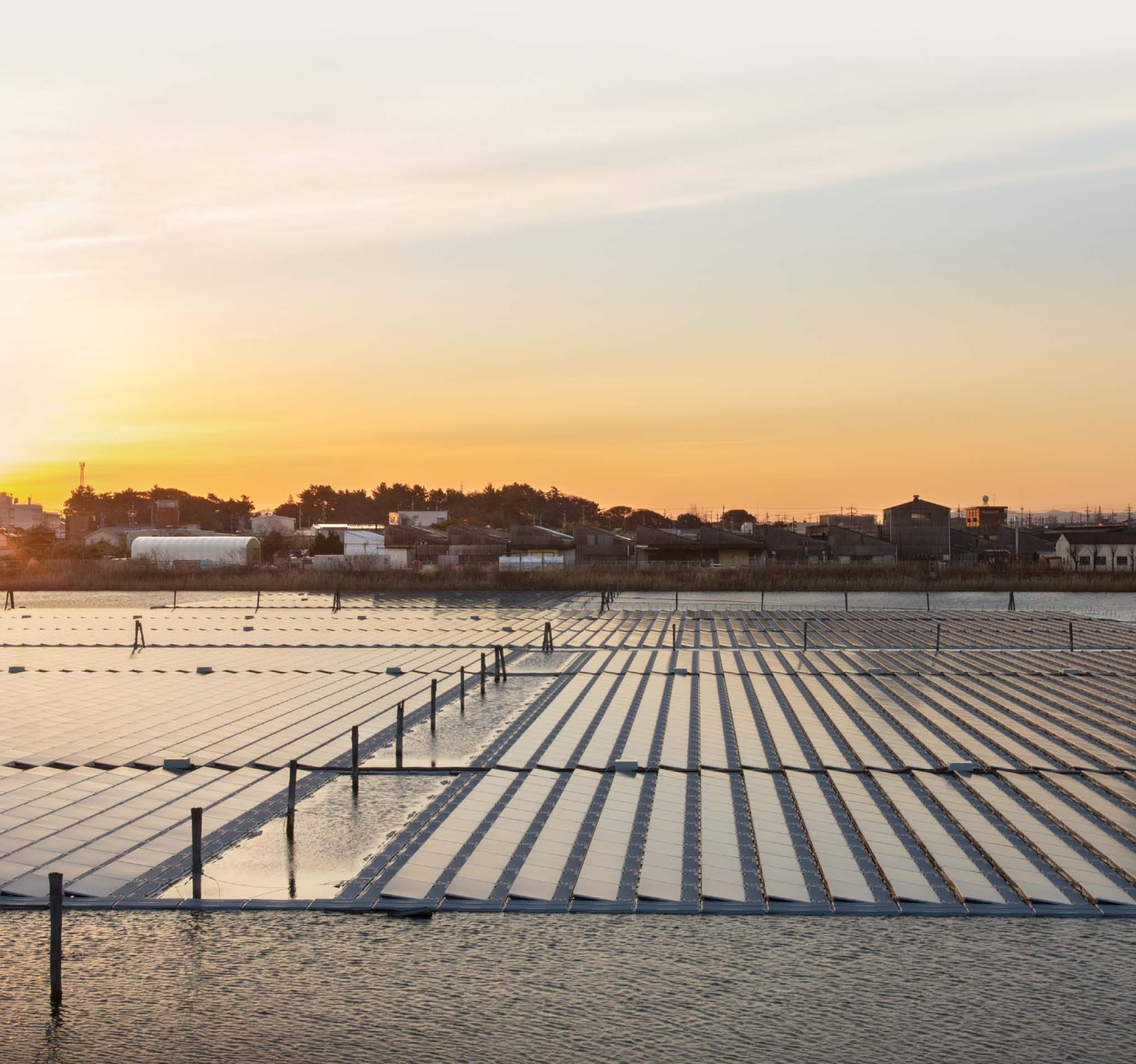
部品サプライヤーが設置した 水上ソーラープロジェクト 日本
