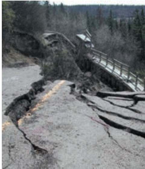
Durch Rutschung zerstörte Strasse in Edmonton.
