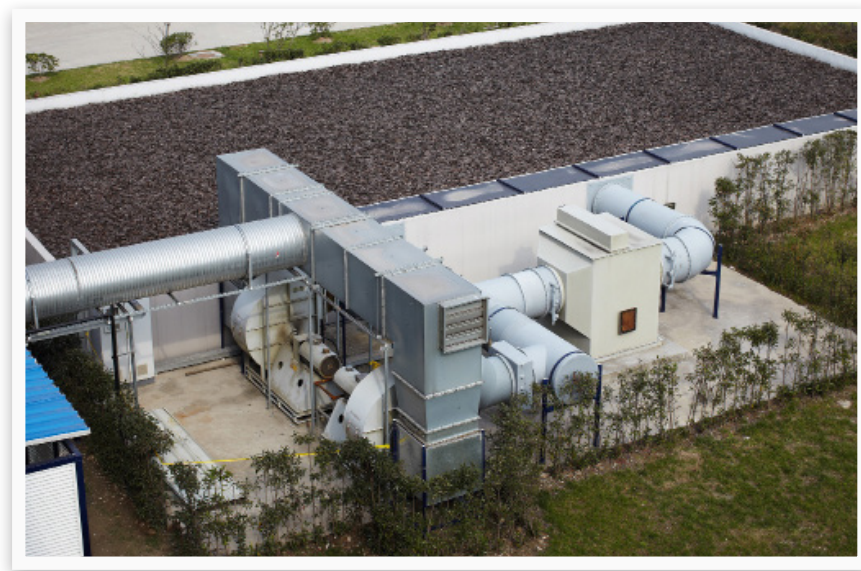
上海供应商工厂废气经过厂房顶覆盖的树皮进行生物过滤。这是工厂气体排放综合管理系统的最后一个阶段。
