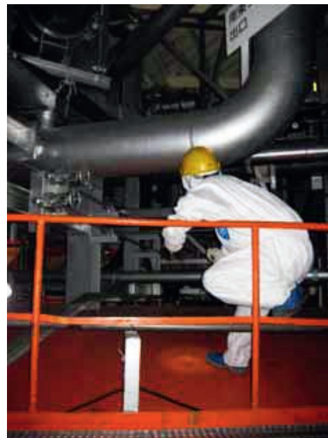
Abbildung 41: Kontrolle des Entlastungsventils im Torusraum (Quelle: TEPCO [7], Attachment 2, S. 129)
