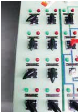
Abbildung 42: Schalttafel des SRV-Systems im Kontrollraum (Quelle: TEPCO [7], Attachment 2, S. 122 – Aufnahme Foto nach dem Unfall)
