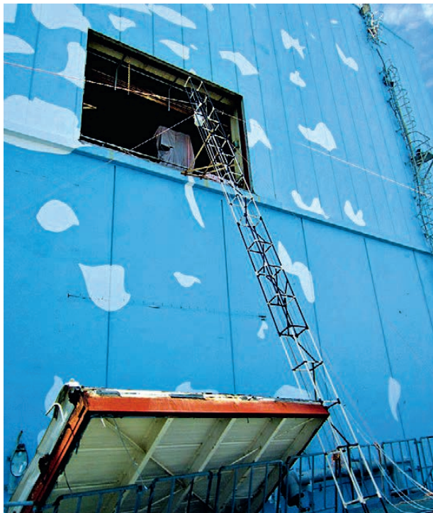
Abbildung 30: Offene Blende (blowout panel) im oberen Teil des Gebäudes von Reaktor 2 (Quelle: TEPCO)
