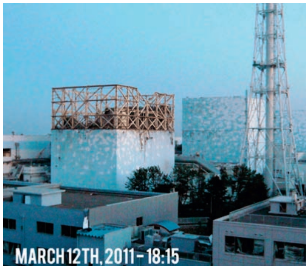
Abbildung 22: Beschädigungen am Reaktorge- bäude von Block 1 nach der Explosion vom 12. März (Quelle: TEPCO https://i2.wp.com/enformable.com/wp-content/uploads/2012/09/その4_031.png )
