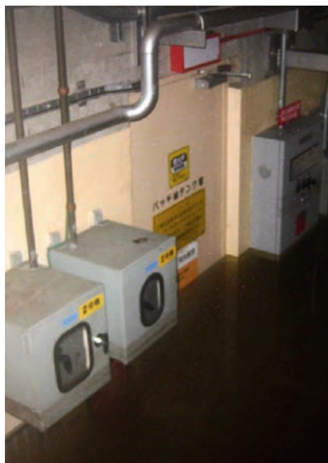
Abbildung 5: Beispiel der Überflutung der Elektroräume des Blocks 2 am Standort Fukushima Daiichi infolge des Tsunamis (Quelle: TEPCO [24])
