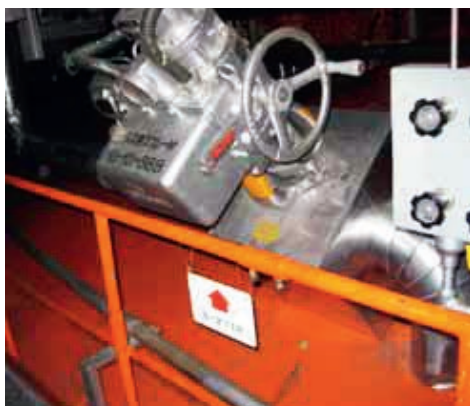
Abbildung 40: Sprühventil des Torus (S/C spray valve) (Block 5 mit Beleuchtung) (Quelle: TEPCO [7], Attachment 2)
