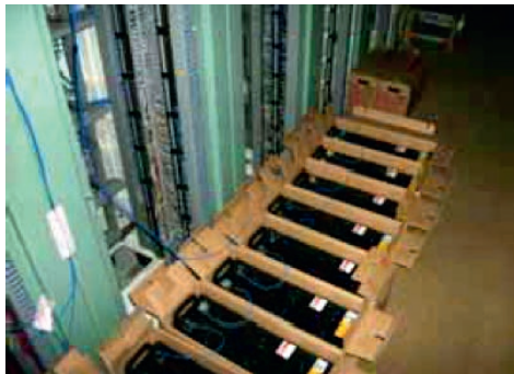
Abbildung 33: An den Schalttafeln im Kontrollraum angeschlossene Batterien (Quelle: TEPCO [7], Attachment 2, S. 91)
