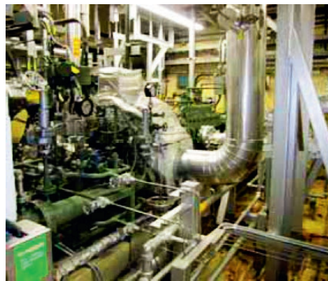
Abbildung 29: Ausrüstung im RCIC-Raum (Quelle: TEPCO [7], Attachment 2, S. 89)
