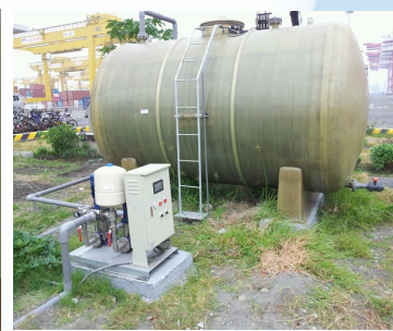
汙水回收設備
