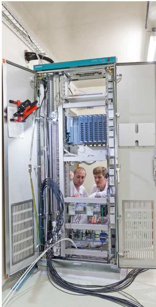
Aufschalten der Kabel im neuen Schwingungserfassungsschrank Foto: KKG
