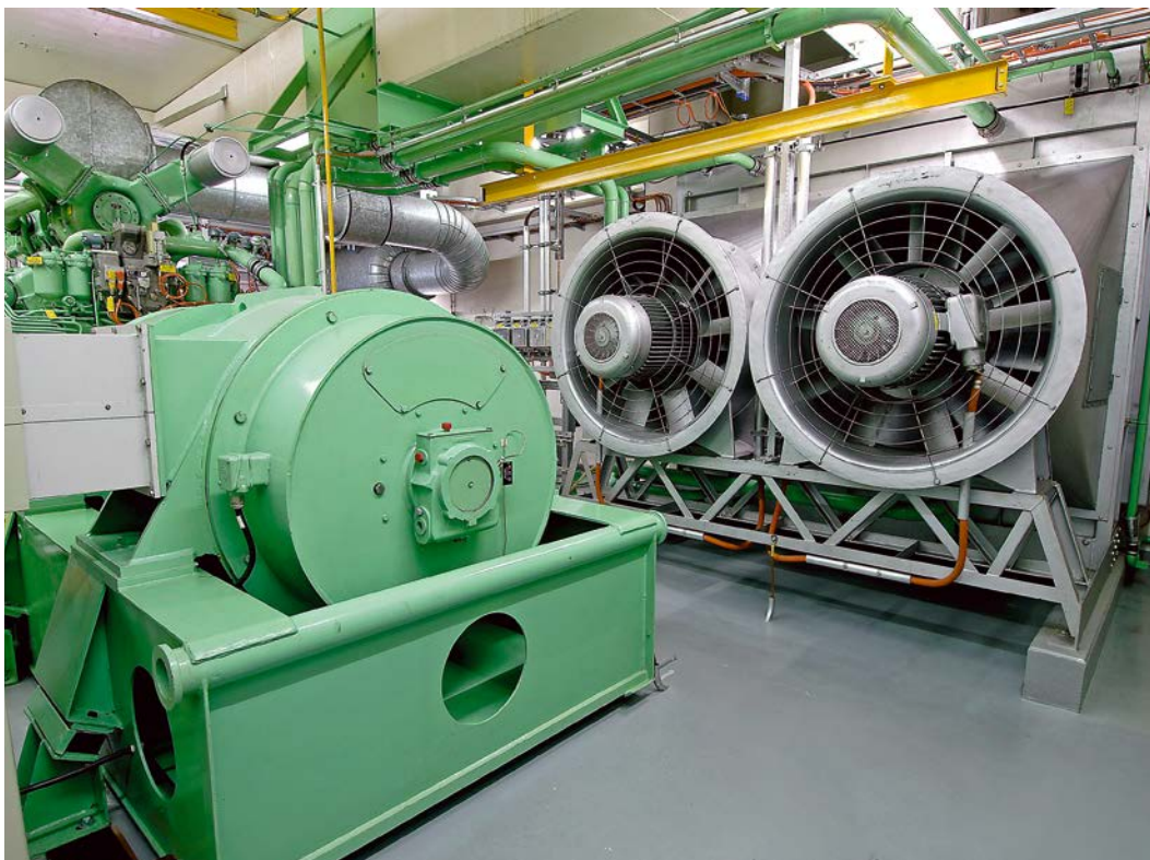
Lüftungsanlage des Dieselraums. Foto: KKM
