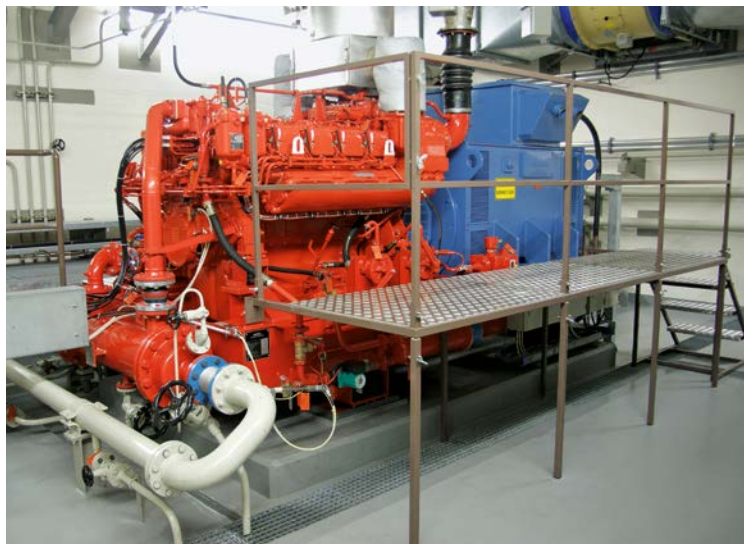
Notstrom- Diesellaggregat. Foto: KKM
