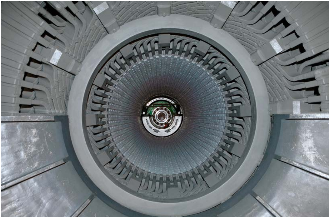
Stator eines Generators des KKM. Foto: KKM
