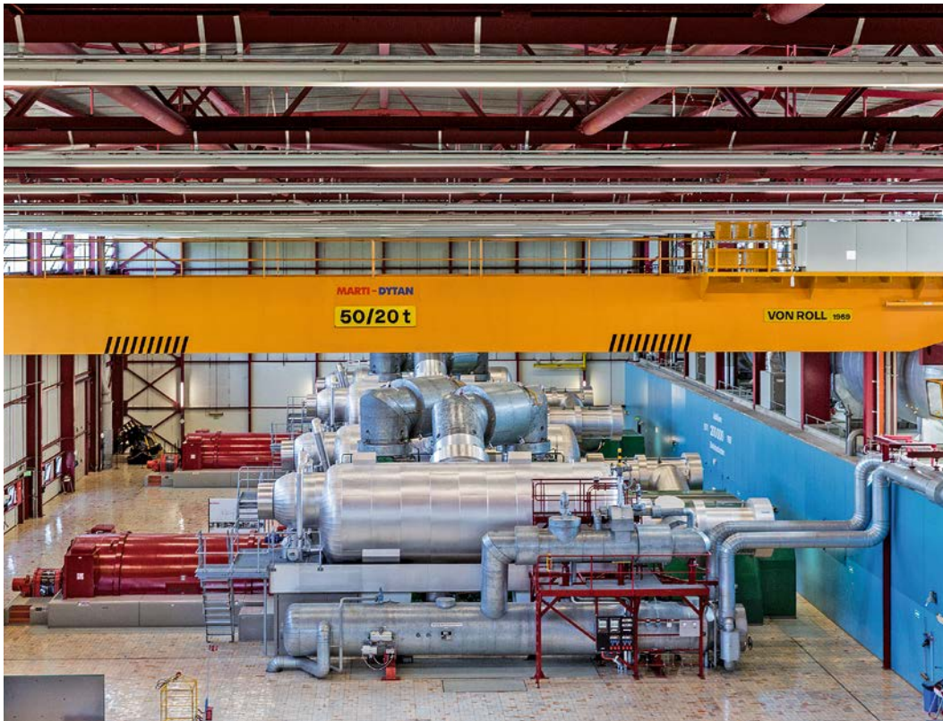
Blick ins Maschinenhaus. Foto: KKB
