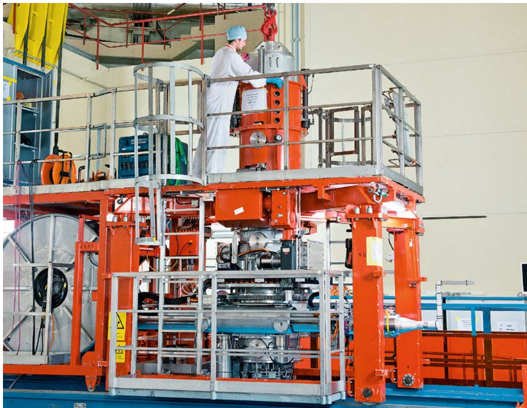
Aufbau des Zentralmastmanipulators für die Schweissnahtprüfung am Reaktordruckbehälter Foto: KKG
