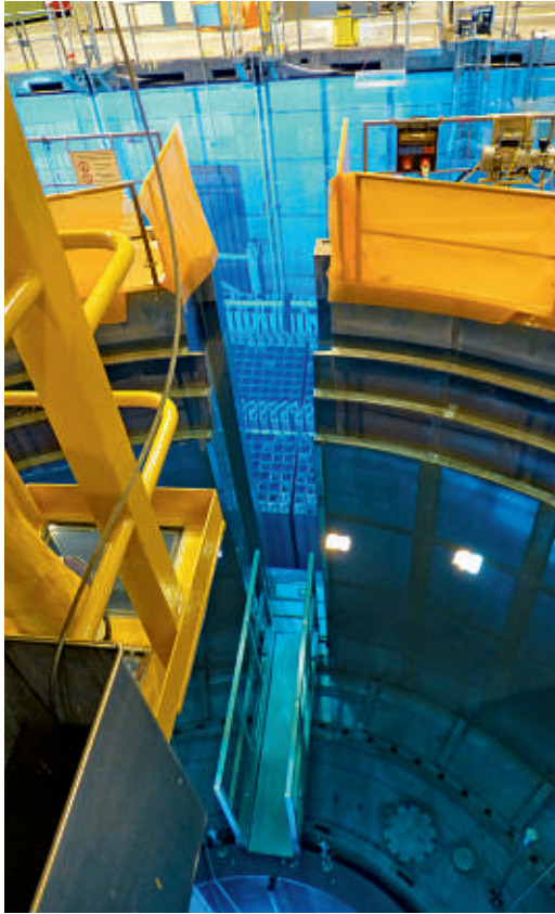
Schleuse zwischen RDB und Brennelementbecken. Foto: KKM.
