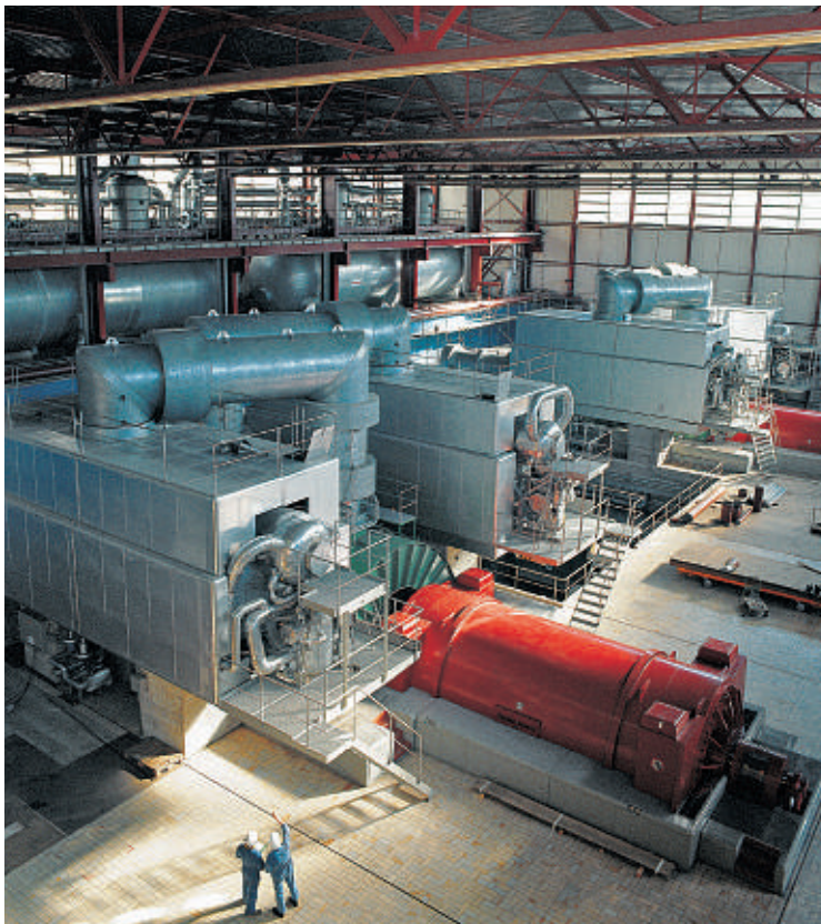
Maschinenhaus mit Turbinen und Generatoren (rot). Foto: KKB.
