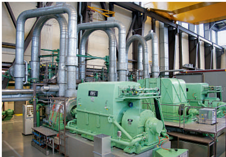
Speisewasserpumpen. Foto: KKM.
