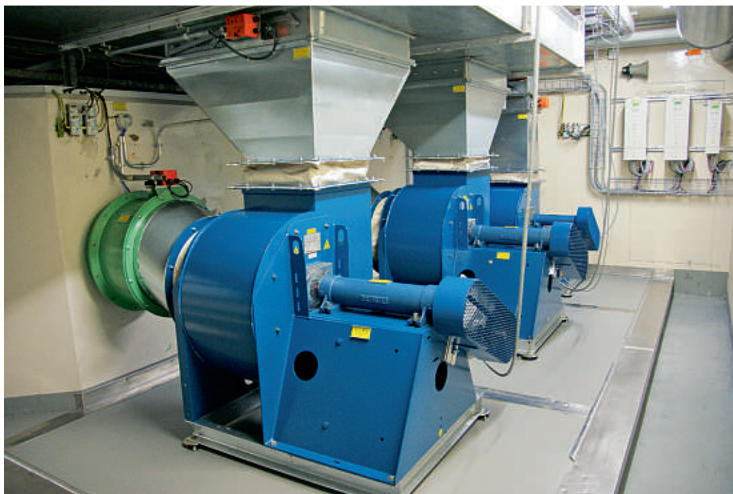
Abluftfilterraum. Foto: KKM.
