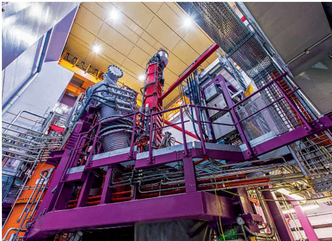
Teilansicht der Plasma-Anlage. Foto: Zwiilag.
