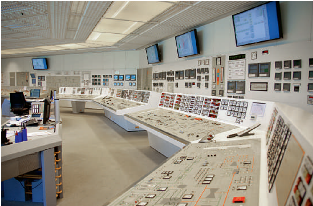
Blick in den Kommandoraum des KKM. Foto: KKM.
