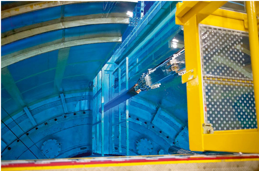
BE-Lademaschine. Foto: KKM
