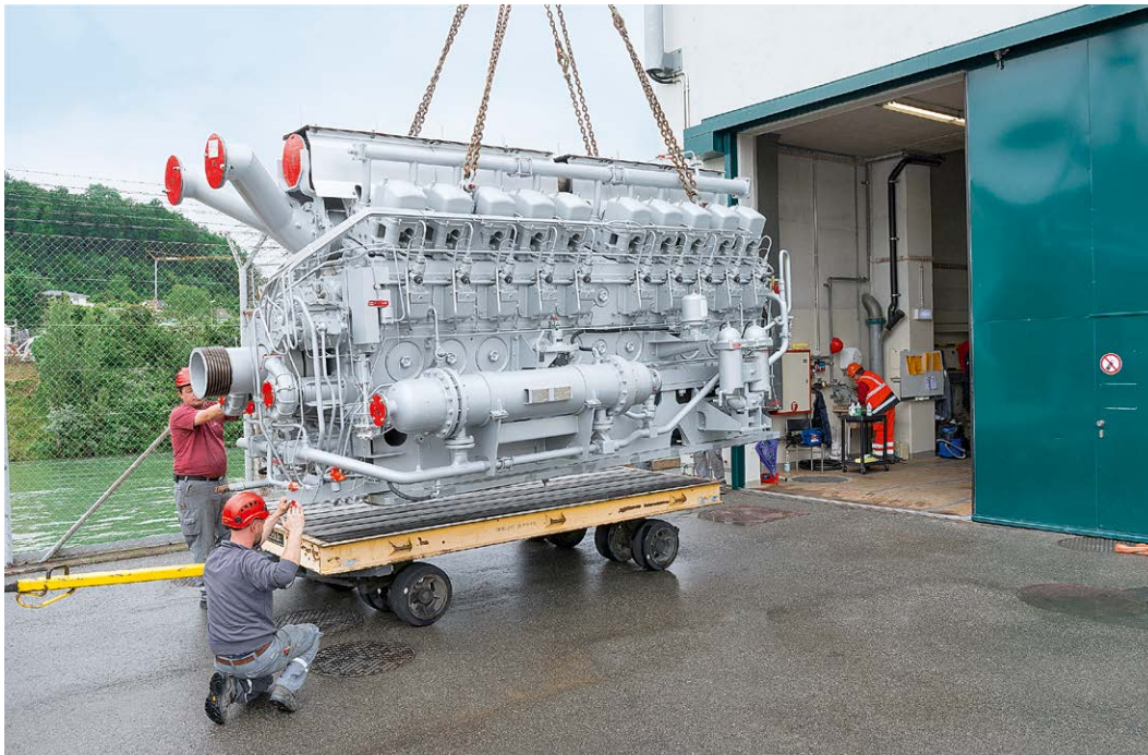
Kühlwasserdiesel für zweite Wasserfassung. Foto: KKG
