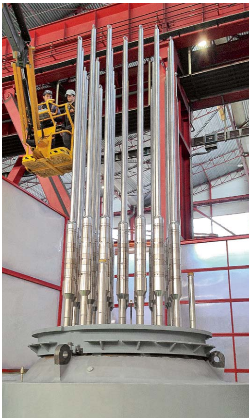
RDB-Deckel mit Durchführungsrohren. Foto: KKB
