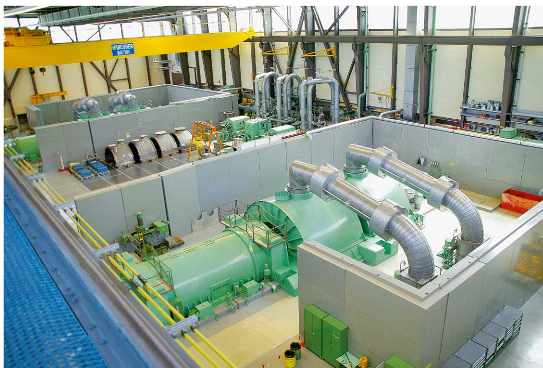
Turbinen im Maschinenhaus. Foto: KKM
