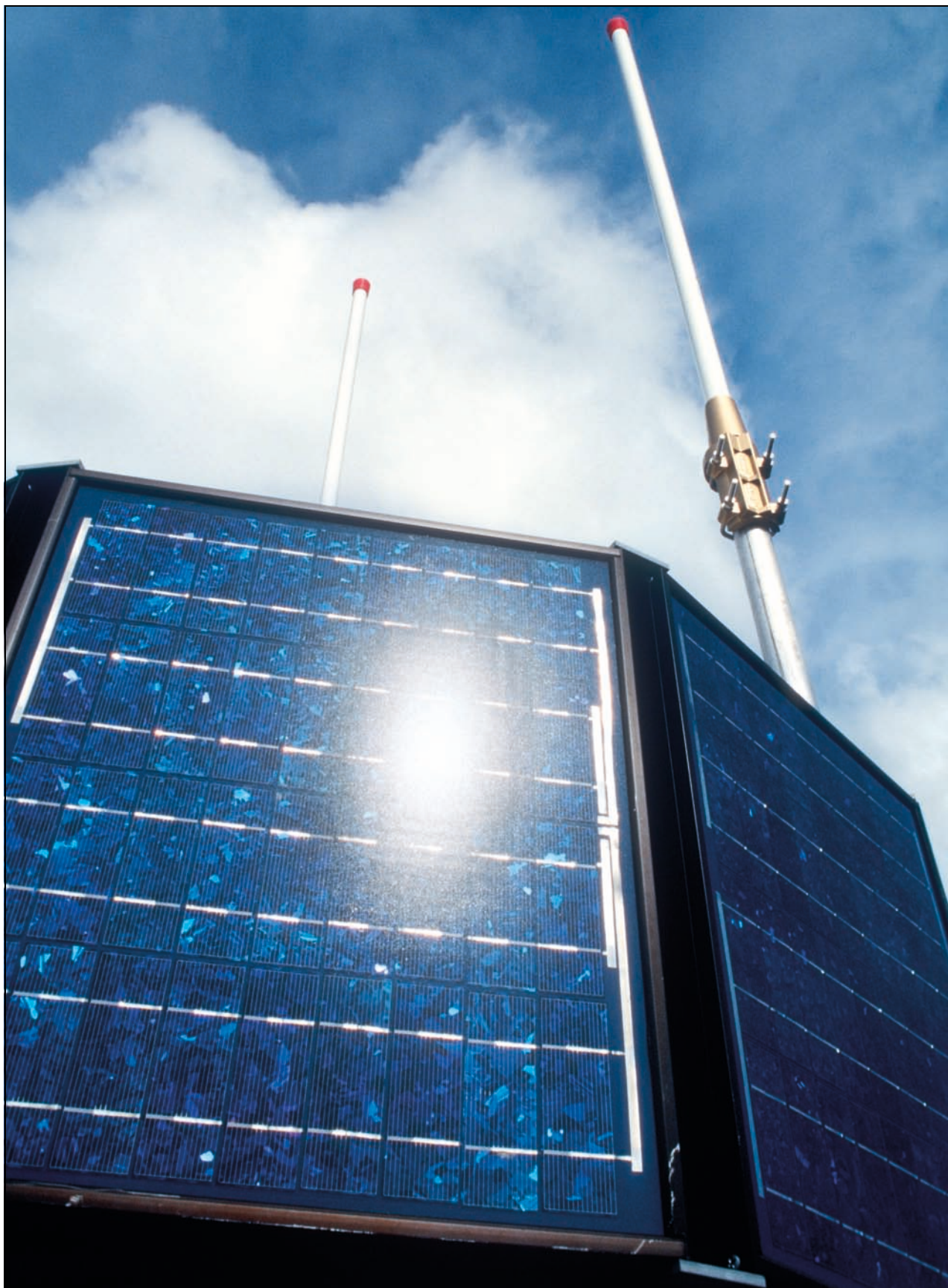
Figur 12.2 Fornybar energi, solcellepanel på linkstasjon i Oppdal, Sør-Trøndelag
