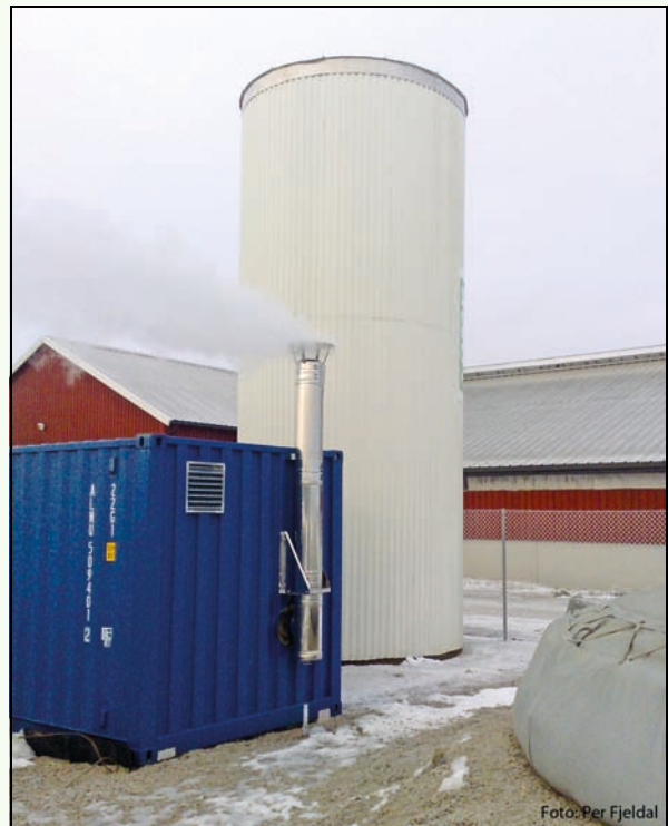
Figur 8.5 Biogassanlegget på Tomb
