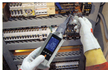
Контроль щита с помощью M-952271
