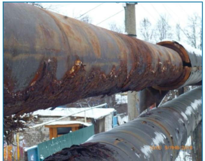
Рисунок 14. Неправильный монтаж скорлуп ППУ с наружной коррозией трубопровода.
