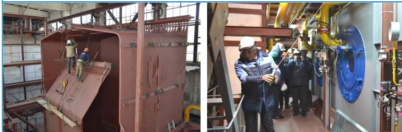
Рисунок 2. ТЭЦ в наши дни, установка современного водогрейного котла.
