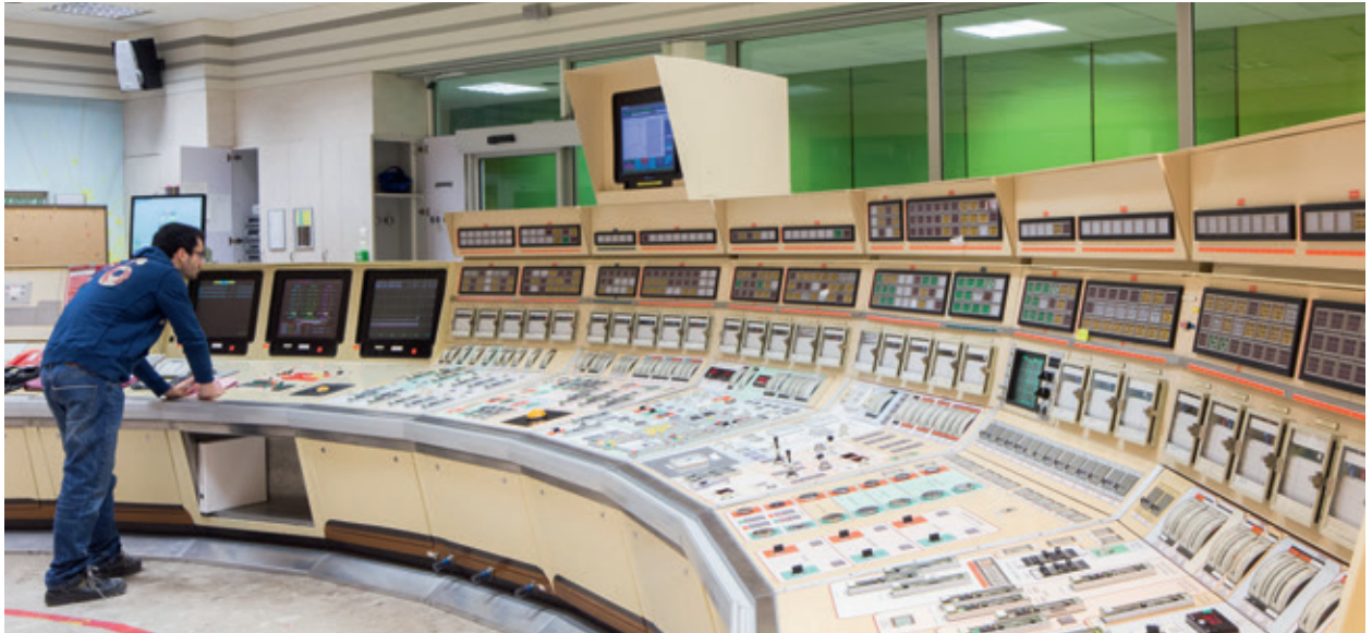
Salle de contrôle. EDF, France
