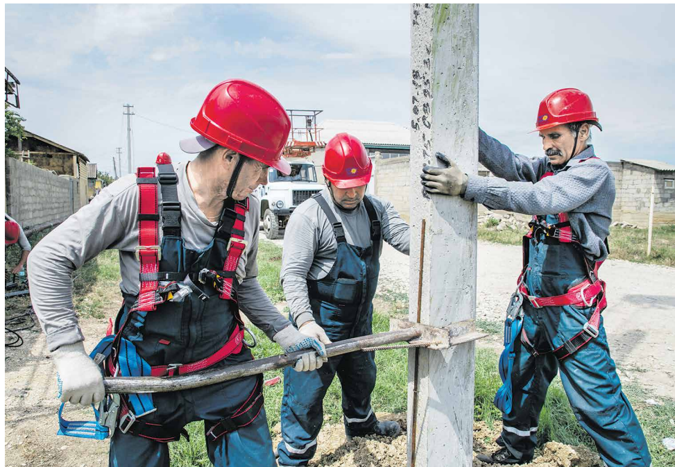
Электромонтеры по эксплуатации распределителей (слева направо): Владимир Стетюха, Евгений Бойко, Павел Агошков
