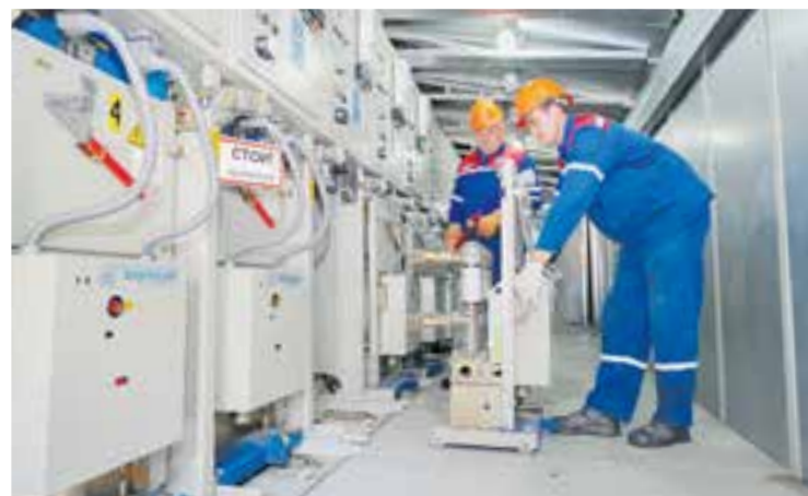
Электромонтеры филиала Севкавказэнерго Сергей Моргоев и Владимир Коломыц вводят в работу выкатной элемент вакуумного выключателя ячейки 6 кВ на ПС 110 кВ «Городская»
