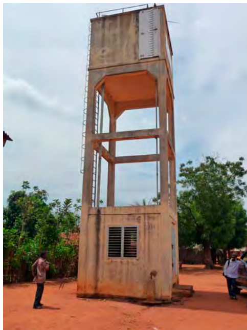
Mono – Château d'eau d'un petit système d'adduction d'eau
