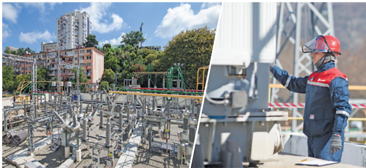
Новые и модернизированные объекты значительно улучшили электроснабжение всего Сочи.
